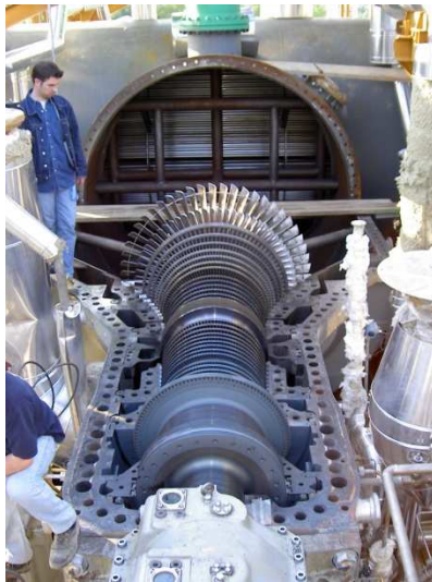
Fig. 1 – Turbina a vapore.
