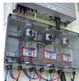
Quadro di campo e manovra (fonte: PVEnergy)
