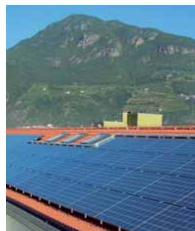
„Impianto su edificio“ (Fonte: Elpo)
