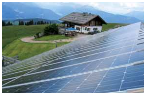
Malga di Verano: uno dei più grandi impianti FV ad isola dell'Alto Adige (fonte: Leitner Solar)
