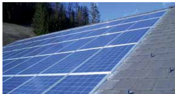
Impianto FV integrato (fonte: Leitner Solar)
